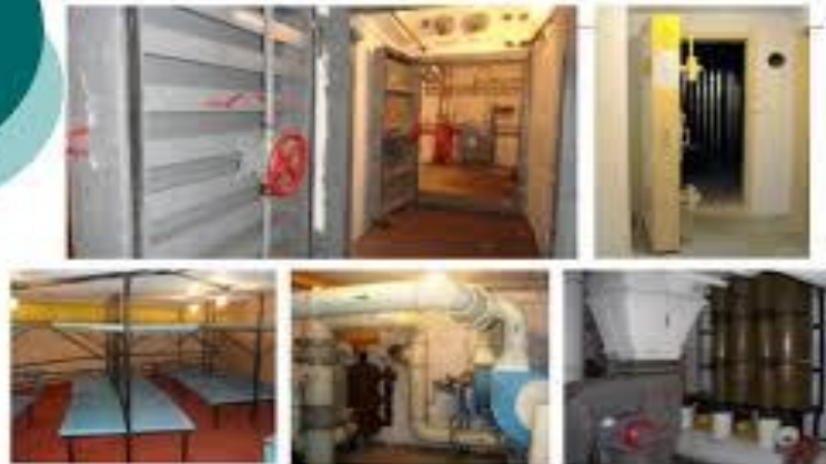
Захисні споруди ЦЗ:
